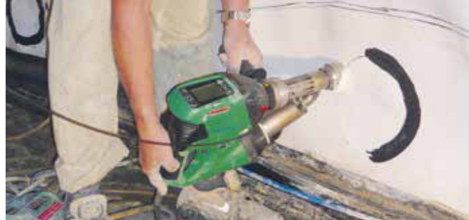
Il robusto WELDPLAST S2 durante la saldatura di una "patch" ("pezza") nella costruzione di tunnel.
