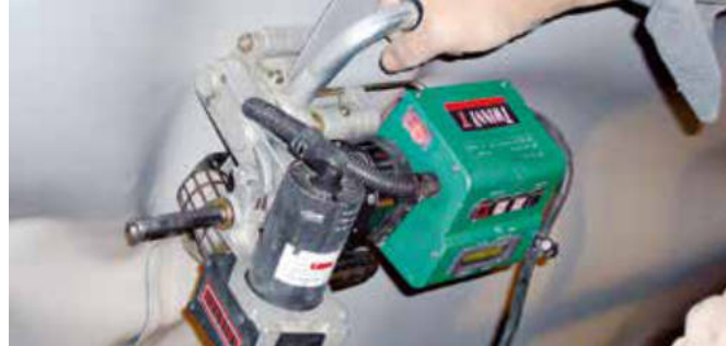
TWINNY T avec poignée transversale pratique pour des soudures en angle au plafond dans un tunnel.
